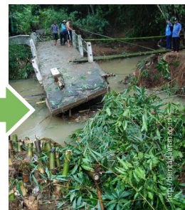
JEMBATAN SETELAH BANJIR
